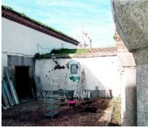
El edificio se encuentra muy deteriorado.
